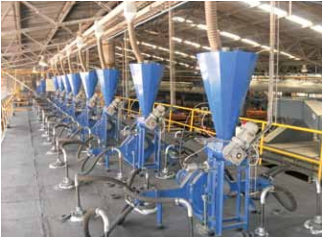
Photos/Fotos: Bernini Impianti
